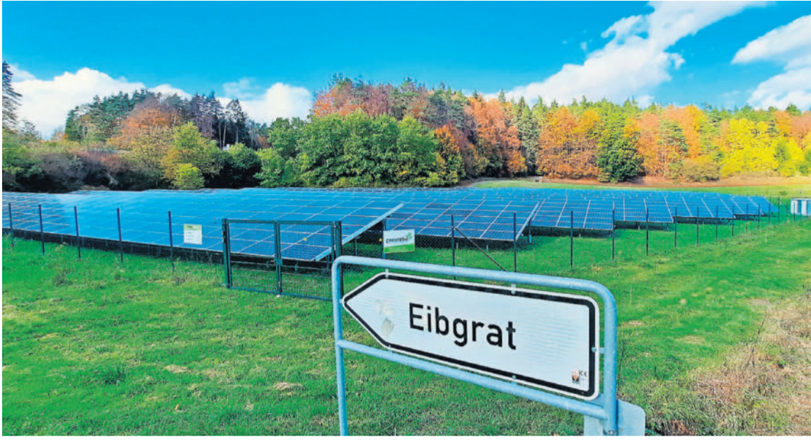
Auch im Neuhauser Gemeindegebiet entstehen mittelfristig zwei Freiflächen-PV-Anlagen: Oberhalb des Ortsteils Höfen und bei Hammerschrott. Foto: Brigitte Grüner
